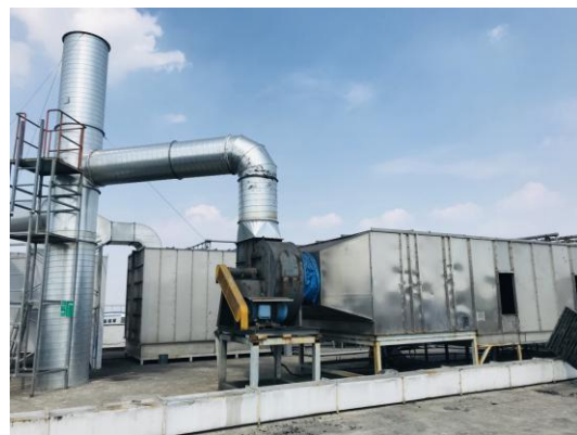
图 3-11 水帘+过滤棉+活性炭吸附装置
