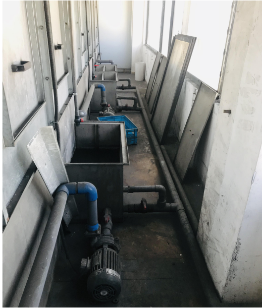
图 3-5 打磨废水过滤设施
