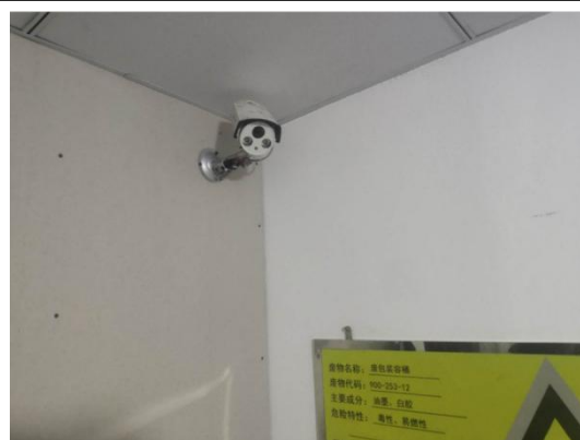
危废仓库内部摄像头
