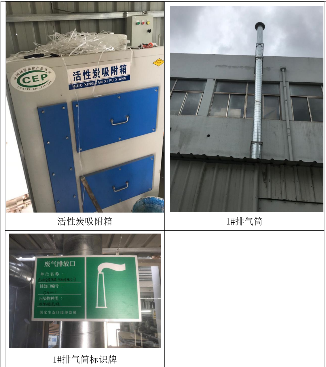
图3-4 废气处理设施及排气筒
