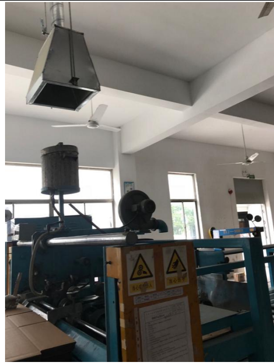
粘合废气集气罩及废气收集管道
