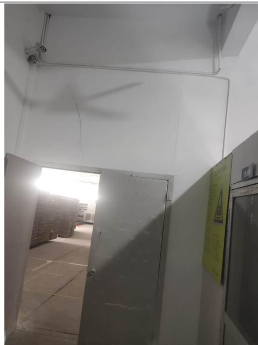
危废仓库外部摄像头
