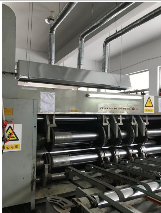
印刷废气集气罩及废气收集管道
