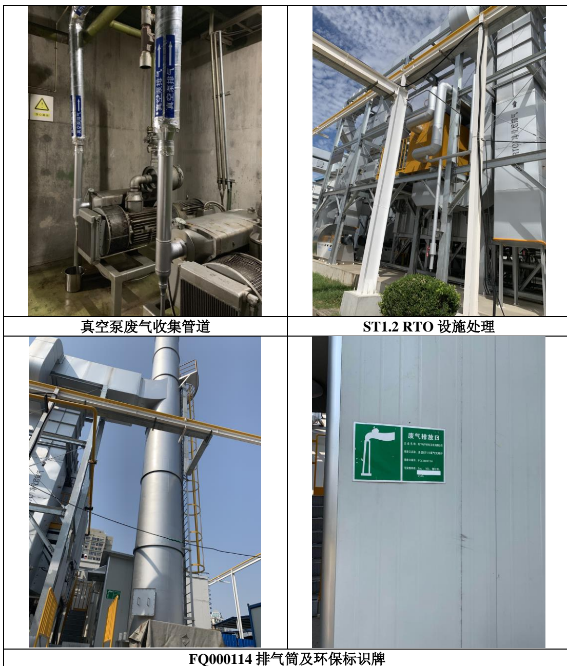
图 3-2 废气处理设施及排气筒
