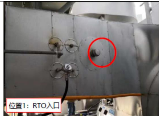
RTO 进口采样口照片
