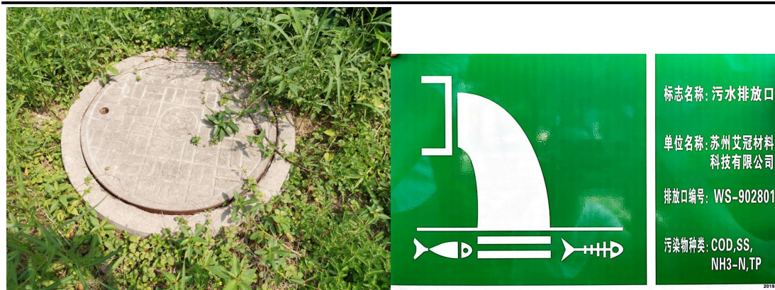
图3.1 项目污水总排口
