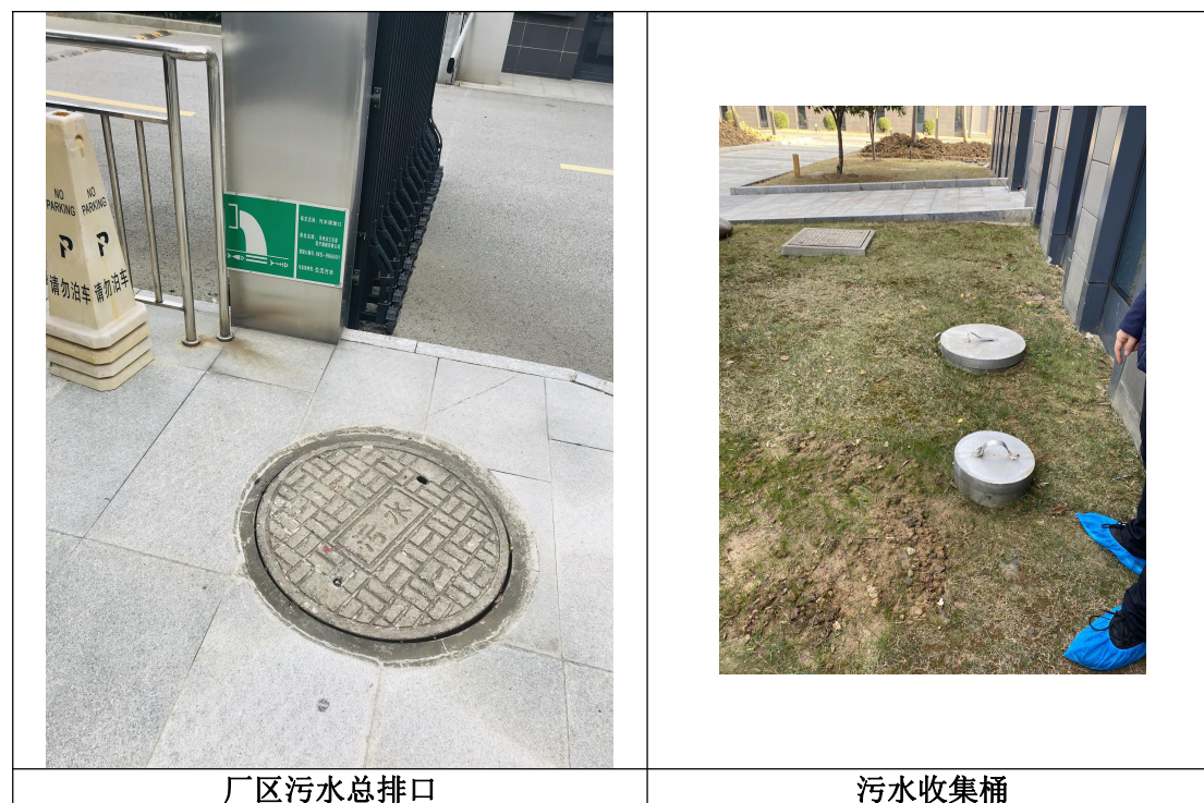
图 3-1 雨污水总排口及生产废水收集桶
