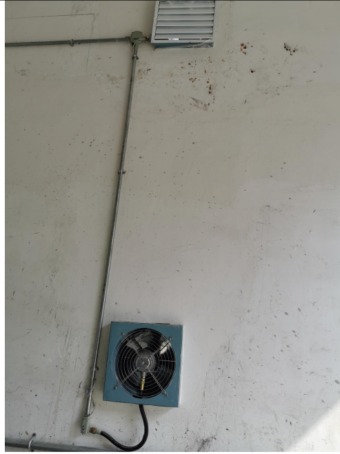
图 3 危废暂存区排风系统
