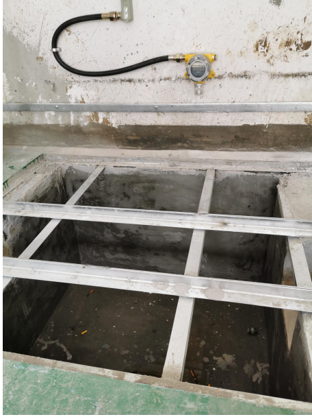
图 2 危废暂存区防泄漏槽照片
