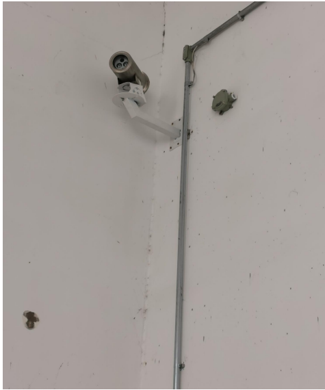
图 4 危废暂存区摄像头照片
