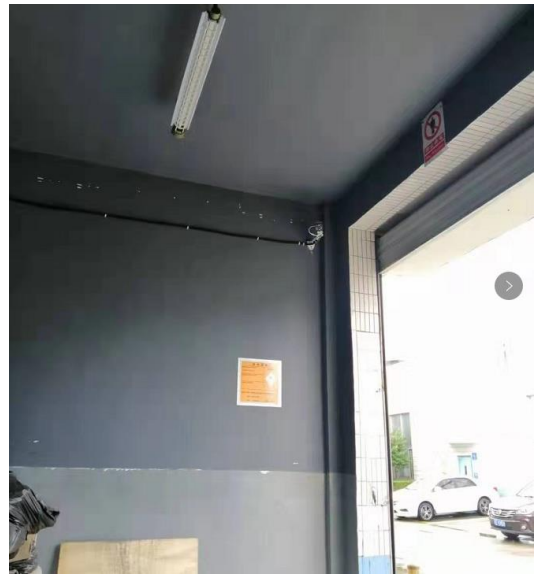
危废仓库内视频监控 2
