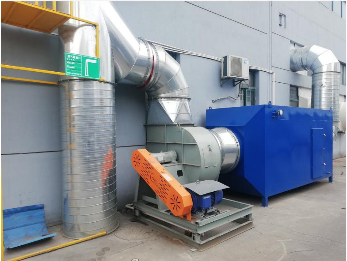
附件 12 处理设施及环保标识牌照片
