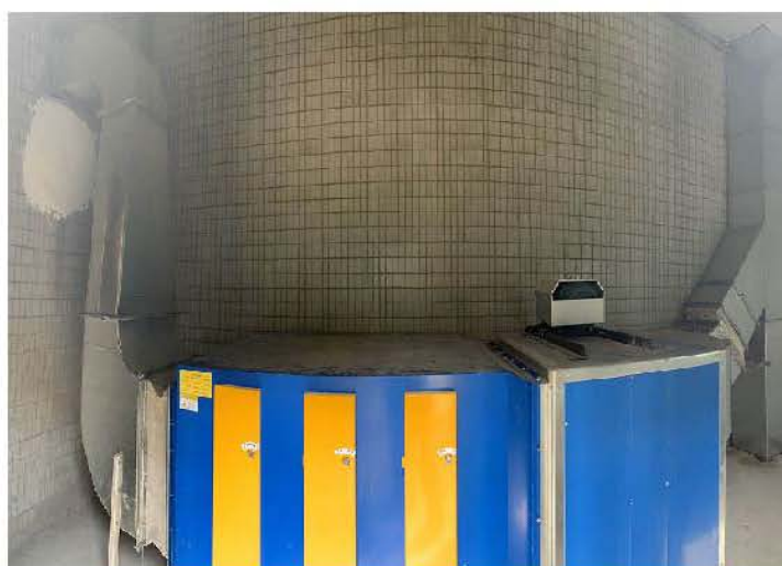
废气处理设施
