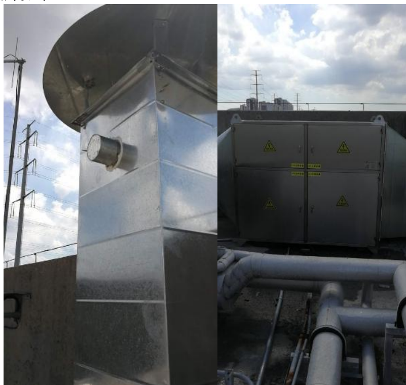
废气排气筒出口
