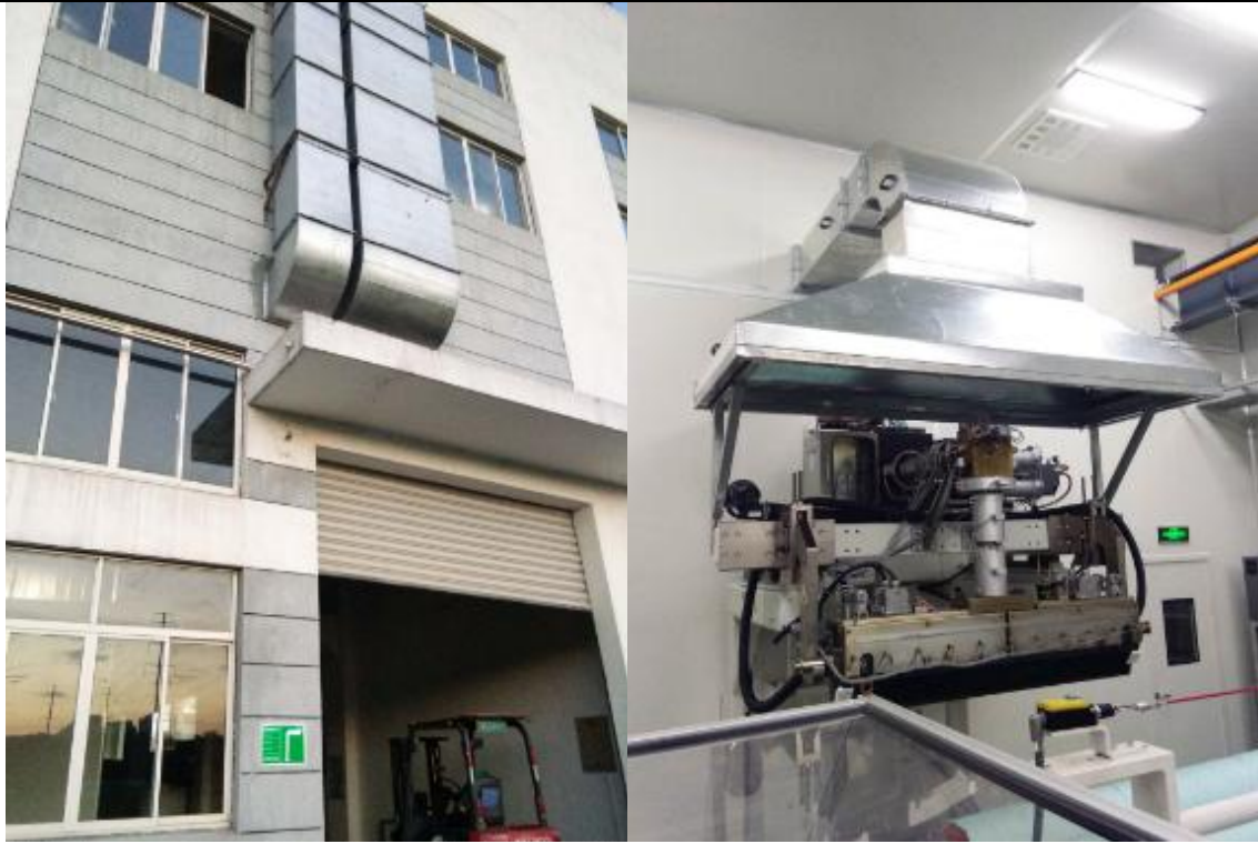
废气排气筒标识牌
